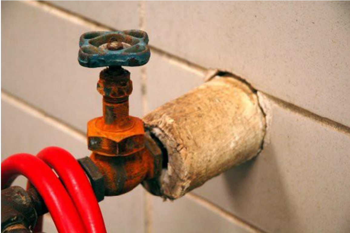
保温管脏而且破裂的生锈的水龙头。 Lm 可能传播到软管中，然后在企业内散布。
